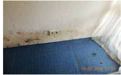
Schimmel hinter einem Schrank an der Innenwand aufgrund einer langjährigen Undichtigkeit des Abwasserrohrs an der Dusche
